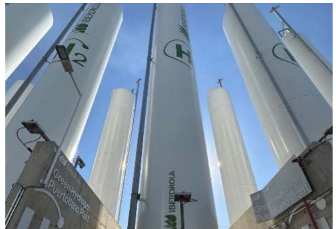
グリーン水素貯蔵設備
