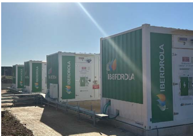
同じ敷地内にある蓄電設備
